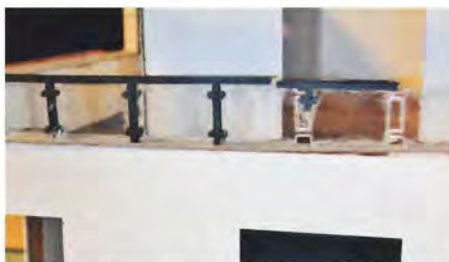
Her ses, hvordan selv moderne huse byder på byggesjusk... der mangler et stykke af gelænderet.
