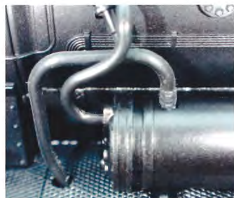
Rørføringerne synes at være komplette.
