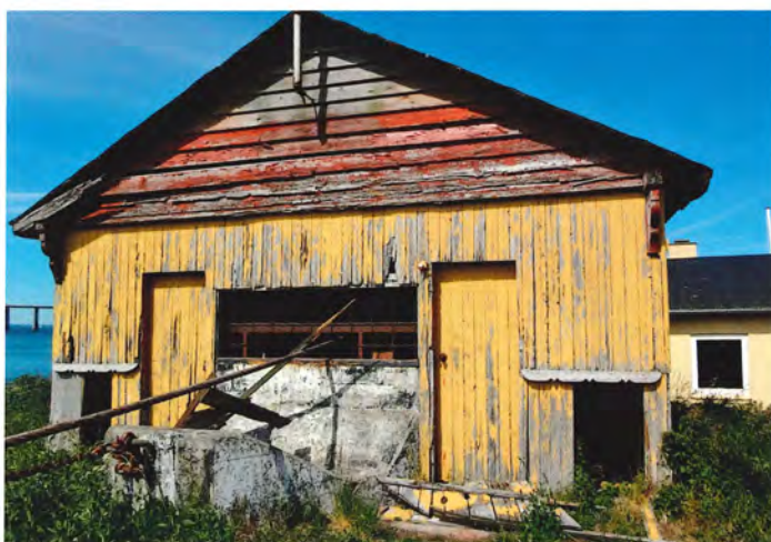
Det er nemt at se, at bygningen trænger til mere end en kærlig hånd for at overleve.
