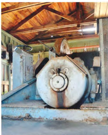
Et kig ind i maskinhuset med den store, elektriske spil-motor.
