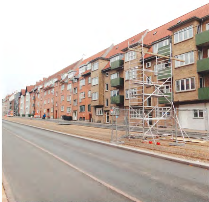
To steder på Nyborgvej var der sat midlertidige stativer op for at holde tråden oppe. Midt i juli var stativerne fjernet igen.
