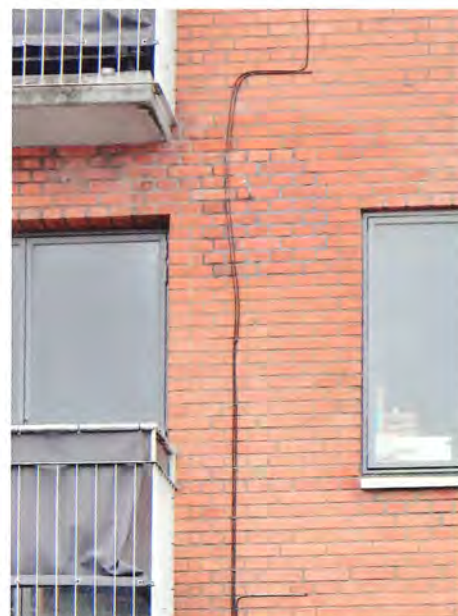
Her kan det vist fornemmes, at muren har taget skade af køretrådsophænget.
