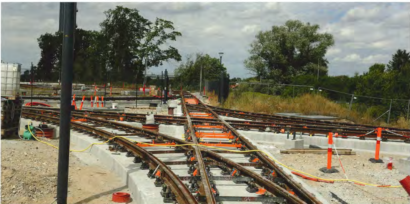
"Diamanten" ved indkørslen til KVC. Reelt en forvokset "engländer", hvor der ligger en kurve mellem højre og venstre spor bagst i billedet. Foto: Finn Frøsig
