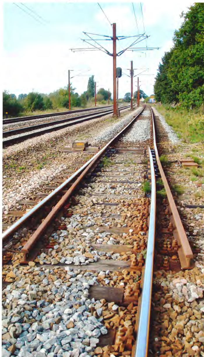
Afløbssporskiftet set mod Odense den 2. oktober 2008. Her ses det tydeligt, at der hverken er hjertestykke eller tvangsskinne.
