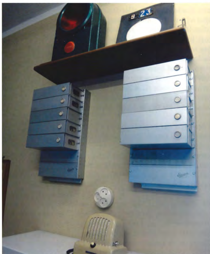
I relærummet finder man en del ældre sager. Sporskiftesignalet er fra Svendborg banegård, sporskifte S 23, der lå ved Toldboden. I boksene nedenfor er der telefonrelæer.
