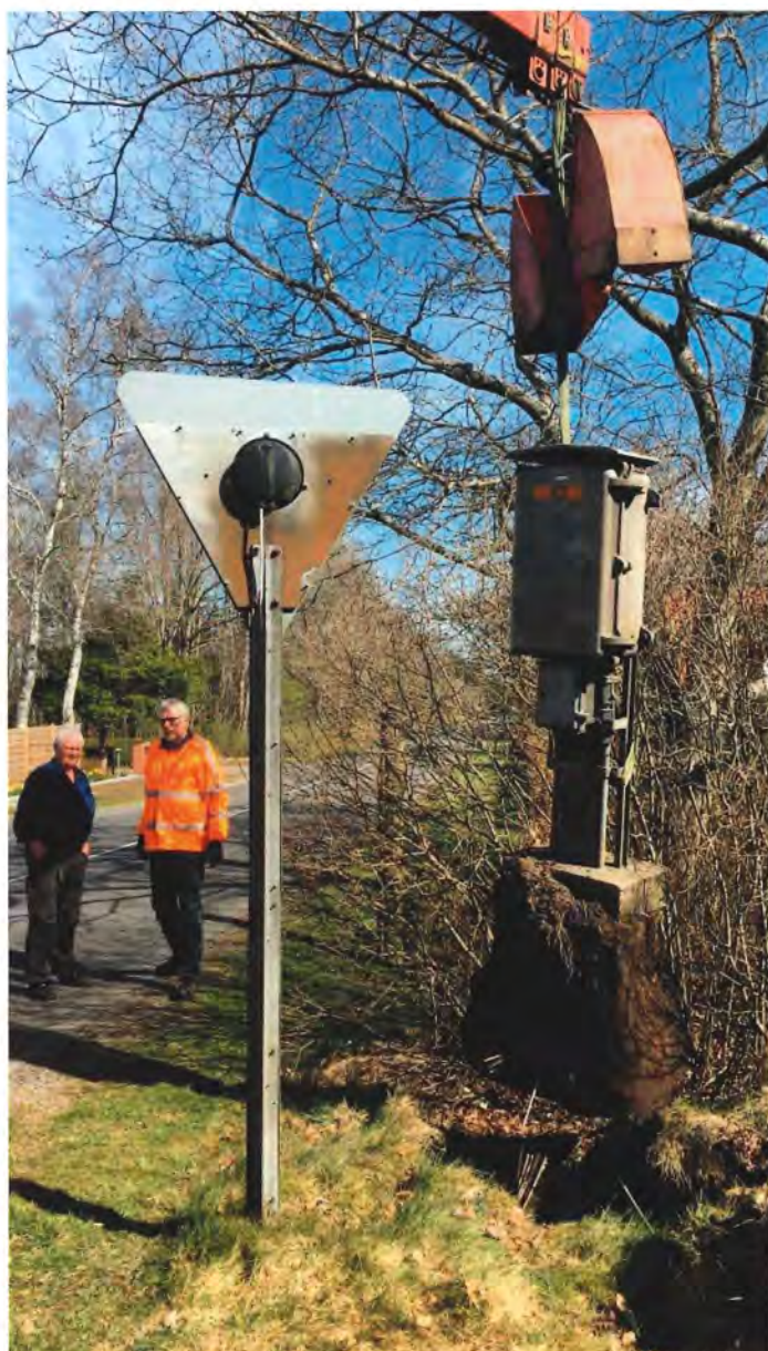
Et skab på Vesterhedevej tæt ved Grindsted er blevet gravet fri og løftet op som det første. Kabler klippes, men her var strømforsyningen forinden afbrudt med en totalt nedsmeltet automatisk sikring i selvstændigt skab.
