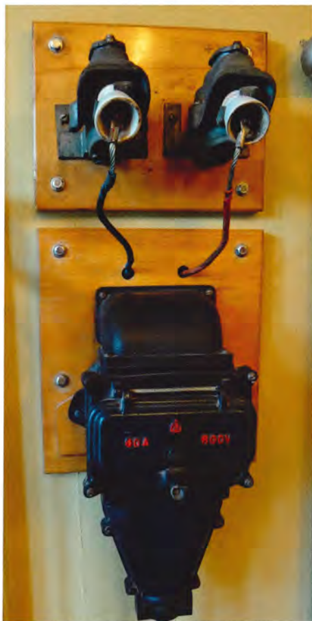
Nærbillede af nødforsyningsanlægget.
