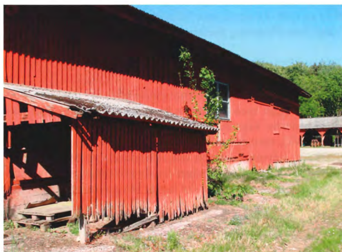
Forfalden bygning på Hvidkilde Savværk, den 6. juni 2015. Foto Flemming Søeborg..
