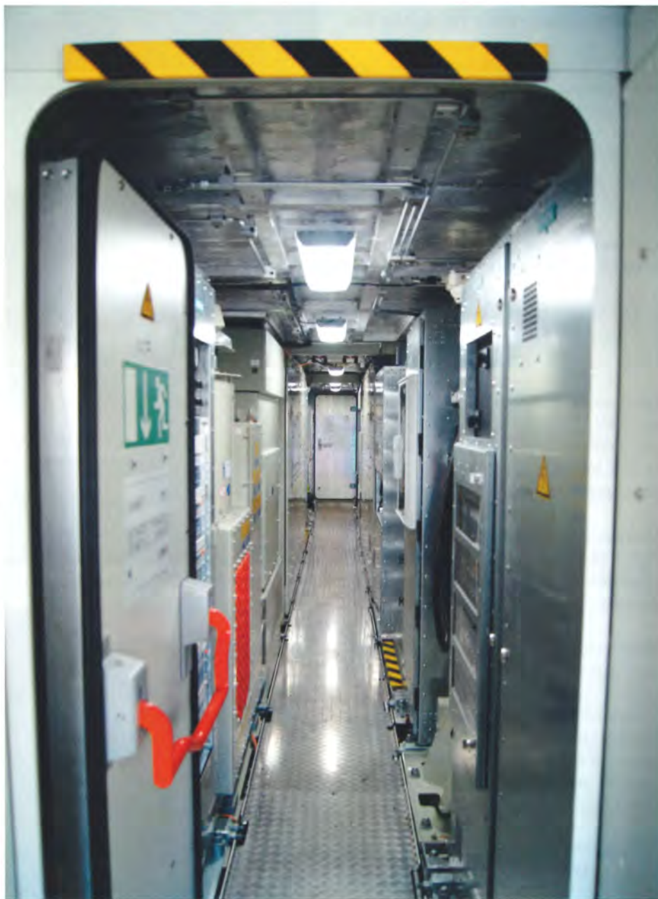
Maskingang fra Førerrum 1 mod Førerrum 2 - en lys og 'venlig' arbejdsplads.
