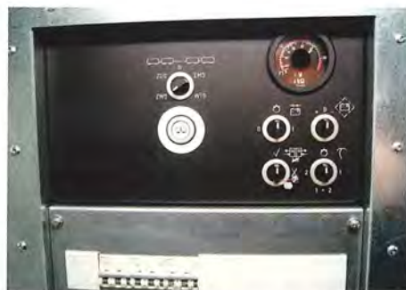
Lavspændingsskab og valg af fjernstyring, strømaftager m.m.
