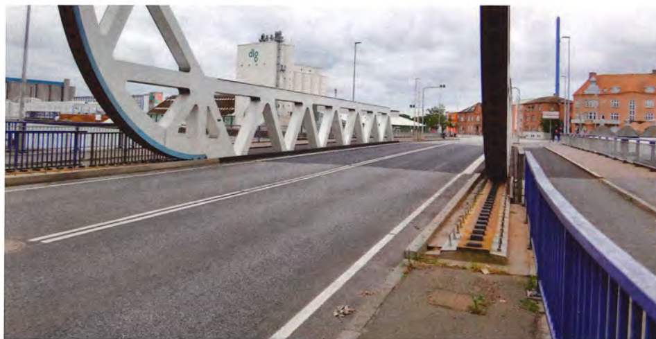
Midt på broklappen i højre vejbane ligger der stadig jernbaneskiner som et minde om bedre tider
