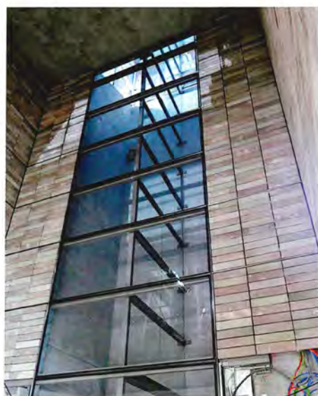
Elevatorskakten på Nuuks Plads. De nye stationer bliver født med to elevatorer. Vægbeklædningen er afstemt med bygningsfacaderne i lokalområdet. Foto Metroselskabet.
