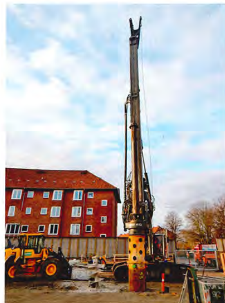
Sekantboremaskine, normalt to stk. på hver plads. Foto Metroselskabet.
