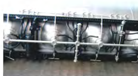
Især undersiden er fyldt med håndtag, ventiler, rørforbindelser og meget andet.
