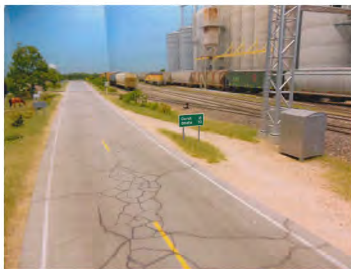
En lidt dårligt vedligeholdt vej, revner er malet på med en fin pen, ved større revner ridser man først med en spids genstand.
