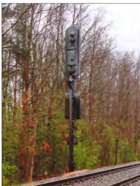
Bagsiden af Køges sydlige indkørselssignal i 2015, godt patineret. bemærk også telefonen helt til højre. Foto SoB.
