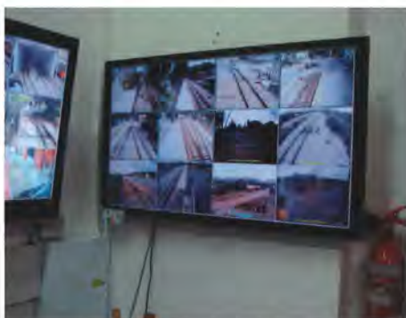
På stationskontoret i Sóller kan man overvåge hele strækningen på flere storskærme. Foto Spor og baner.
