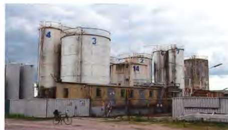
Foto fra 2013 - Tankene nr. 1 - 7 er de oprindelige tanke. I de senere år har tankene været hvidmalede, selvom det er svært at se for rust og alger.
