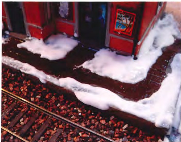
De mørkebrune, blanke fliser tyder på rigelig saltning.
